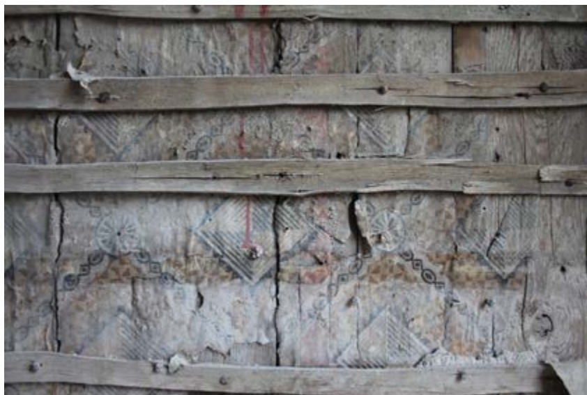
Fig. 3: Papier-peint rabouté au premier étage de la maison quai à la Chaux 4, aujourd'hui démolie © urban.brussels – ULiège.
