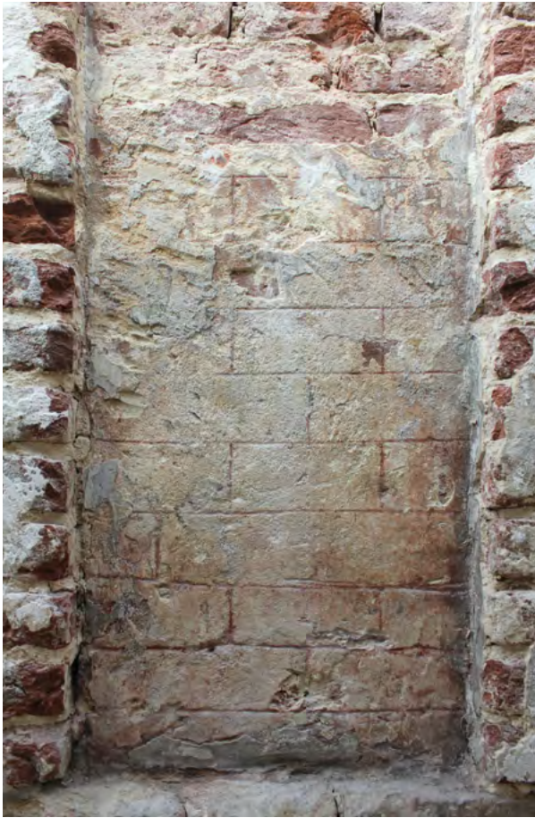
Fig. 3 Vestiges de l'enduit en faux appareil en briques (photo A. Baudry © urban.brussels-ULiège).
