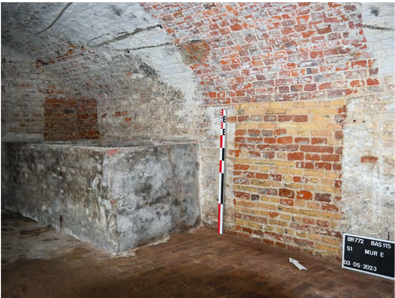
Fig. 2 Mur support oriental et départ de voûte de la cave du secteur 1 de la maison rue du Marché-au-Charbon 37 montrant une maçonnerie homogène constituée de briques de production locale et de briques d'importation © urban.brussels -ULB
