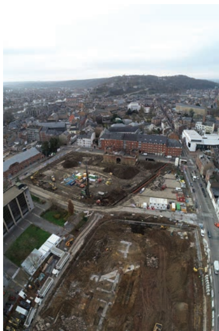
Fig. 1 Vue aérienne du site en cours de sauvetage (Photo P.-M. Warnier © SPW).
