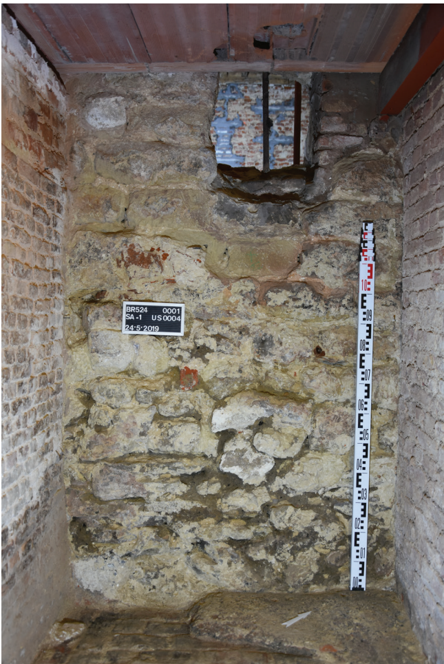
Fig. 3 : Mur ouest de la cave, rue de l'Étuve 49-51 ; en partie inférieure, fondation présentant des traces de terre (© ULB-urban.brussels).
