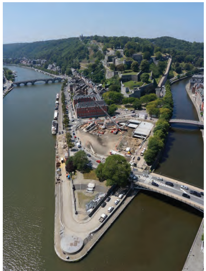
Fig. 1 : Le Grognon en travaux : archéologie préventive et construction du parking souterrain, entre Sambre et Meuse (Photo : P.-M. Warnier – SPW/DGO4-Dir. Géomatique).
