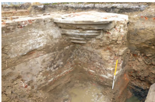
Fig. 2: Noordelijke halfronde toren langs de centrale toegangspoort van het Lanteernhof (Bron: Abo nv, 2018).
