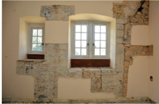
Fig. 2 : Détail de sondages dans des enduits du premier étage, avec mise en évidence de l'emplacement d'une cheminée primitive et des banquettes de la fenêtre de droite. Photo J.-L. Javaux.
