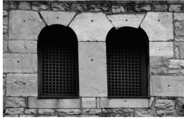
Fig. 2. Trous de pince sur les encadrements des baies jumelées du flanc nord de la tour de l'église Saint-Roch à Soiron © A. Baudry
