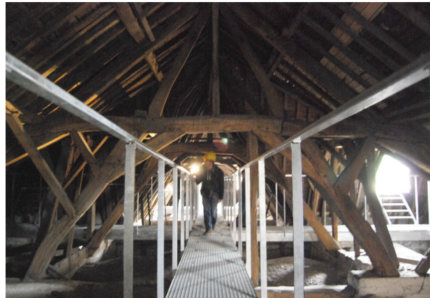
Fig.1 : Visite de prospection sur le site de l'église Saint-Nicolas, Neder-Over-Heembeek © Weitz A., ULg-IRPA.
