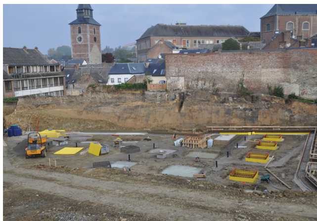
Fig. 3. Vue du chantier vers le nord. Fondations du parking souterrain du nouvel hôtel de ville et à l'arrière plan coupe géologique ouest-est (Michel Siebrand © SPW/DGO4/Serv. archéologie. Dir. ext. Namur).
