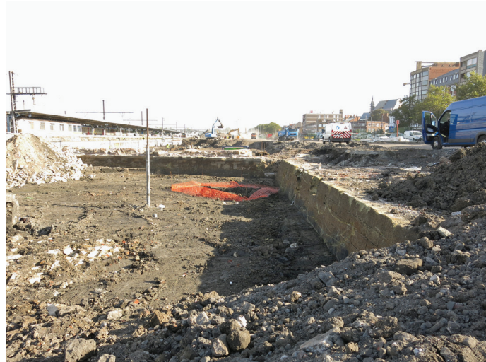
Fig. 3. L'enceinte hollandaise. Le mur de courtine 1-14 avec en arrière-plan le mur de flanc méridional du bastion n°14.
