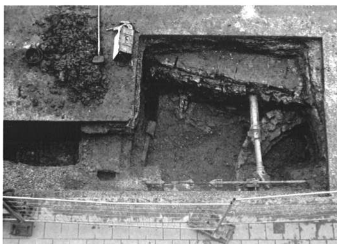
Fig. 1 : Dinant, rue Saint-Martin. Vue de l'extrémité est de la tranchée. A droite, sous la canalisation, l'abside du bâtiment.
