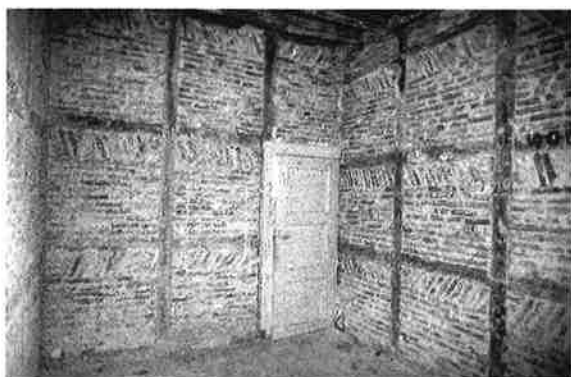
5. Cloisonnement cellulaire en pan-de-bois du premier étage de l'aile Licorne, réalisé dans la première moitié du XVI e siècle (photo : Philippe Géron © In Situ – MRW, DPat).
